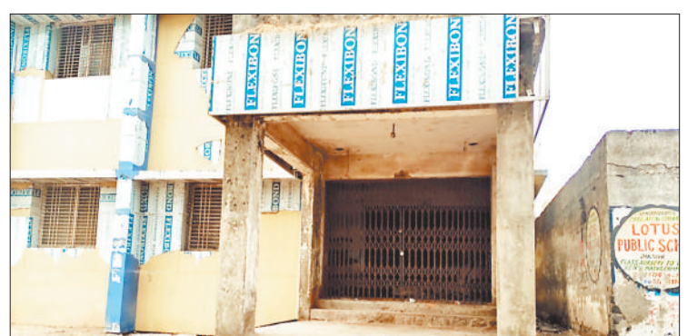
उपयोग के पहले से ही खंडहर में तब्दील हो रहा जिला सहकारी बैंक का नवीन भवन।
